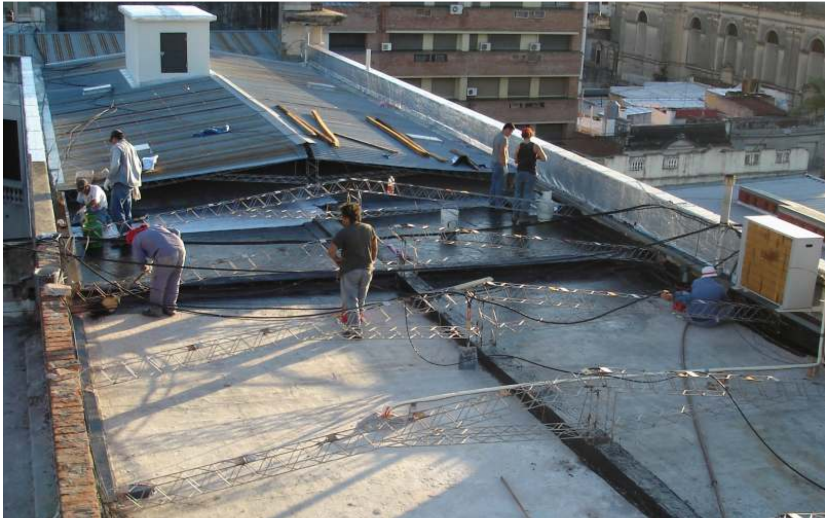
Relevamiento de patologías estructurales y reparación de los techos del edificio de tribunales de la ciudad de Santa Fe. Trabajo encargado por la Corte Suprema de Justicia.
